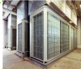
Strojovna v budově
